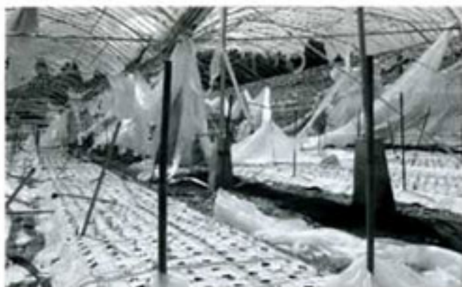
破壊されたトルコキキョウハウス(16号・高森町)
